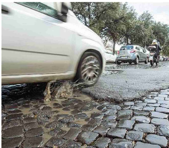
Via dei Cerchi Rattoppi, sampietrini divelti e voragini ovunque (foto Giuliano Benvegù)
