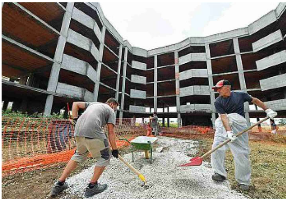
Al lavoro Due operai impegnati in un cantiere nella zona di Tor Vergata (foto Ferrari/Ansa)
